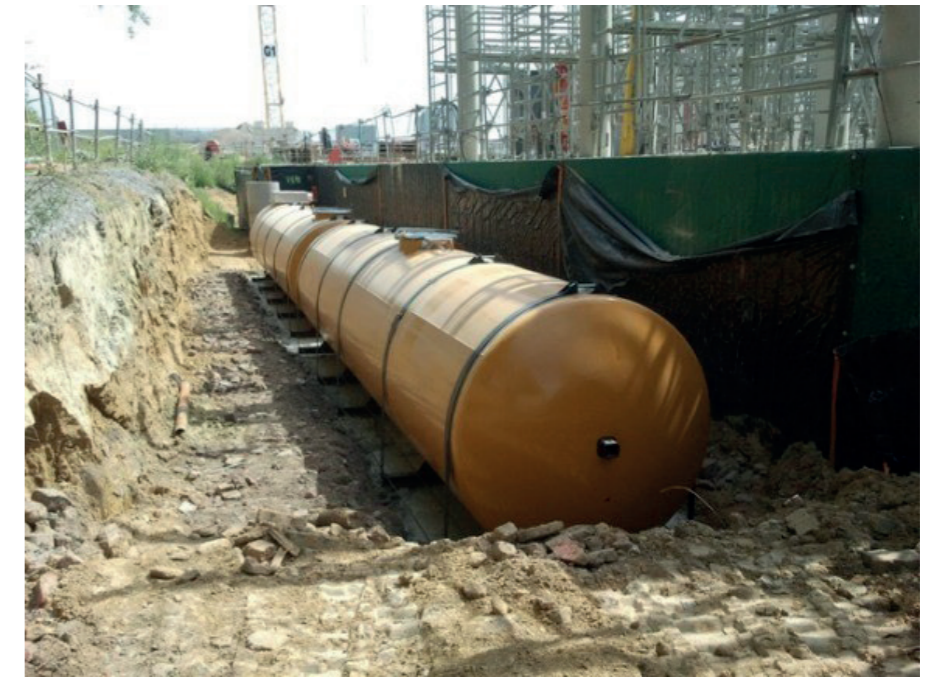
Figure 47 : Cuve de récupération des eaux pluviales enterrée
