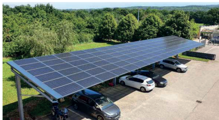
Figure 42 : Panneaux photovoltaïques sur ombrières
